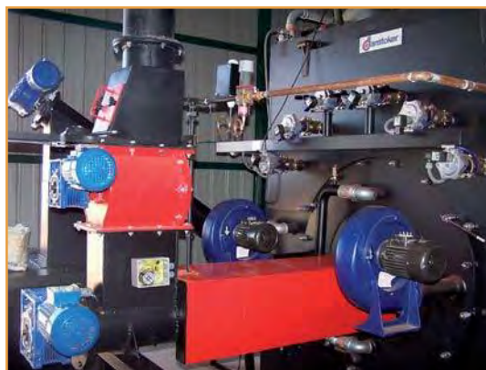
Caldera de Biomasa
