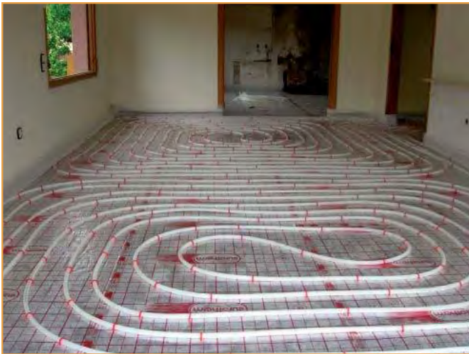
Instalación geotérmica y aplicación en suelo radiante
