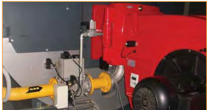
Caldera para sistema de calefacción y ACS centralizado
