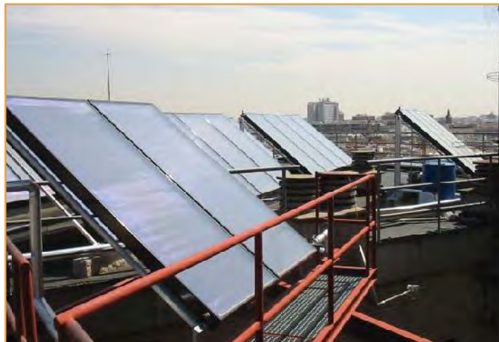
Instalación solar térmica para ACS
