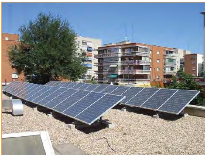
Instalación de paneles solares fotovoltaicos
