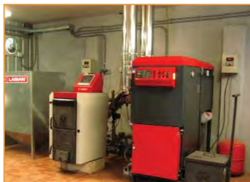
Calderas de baja temperatura
